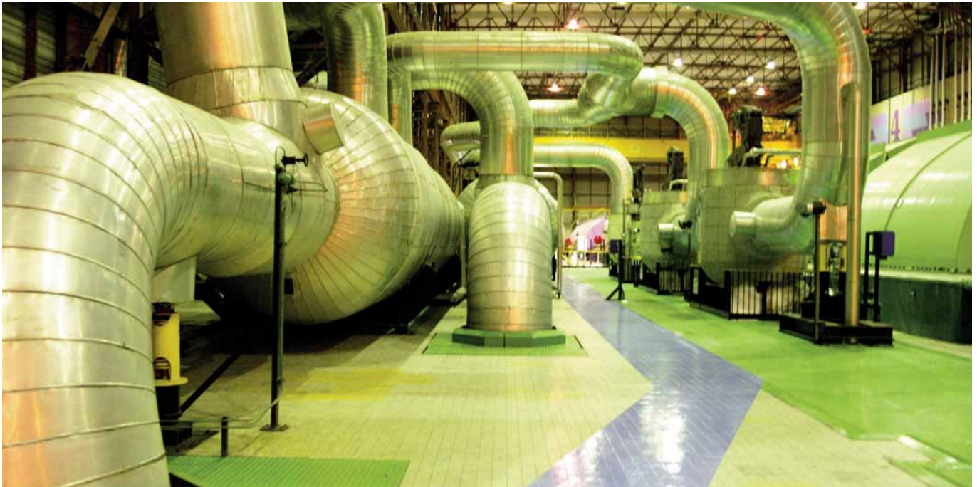
Salle des machines de la centrale de Gravelines - Crédit Photo : Michaël Zumstein
